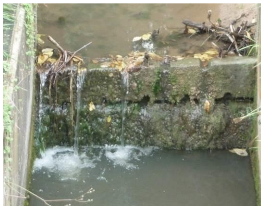
Absturz im Bereich AO2
